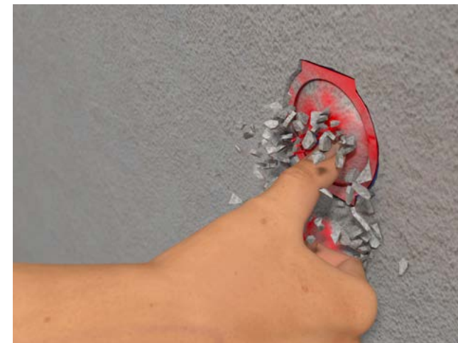
Putzdeckel kann mit der Hand eingedrückt werden...
