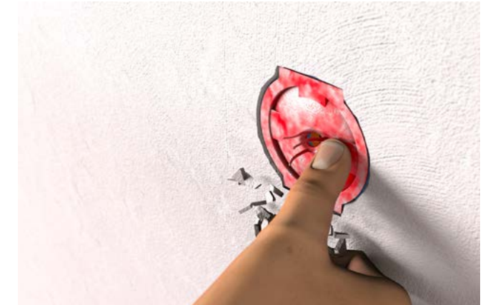
Putzdeckel kann mit der Hand eingedrückt werden ...
